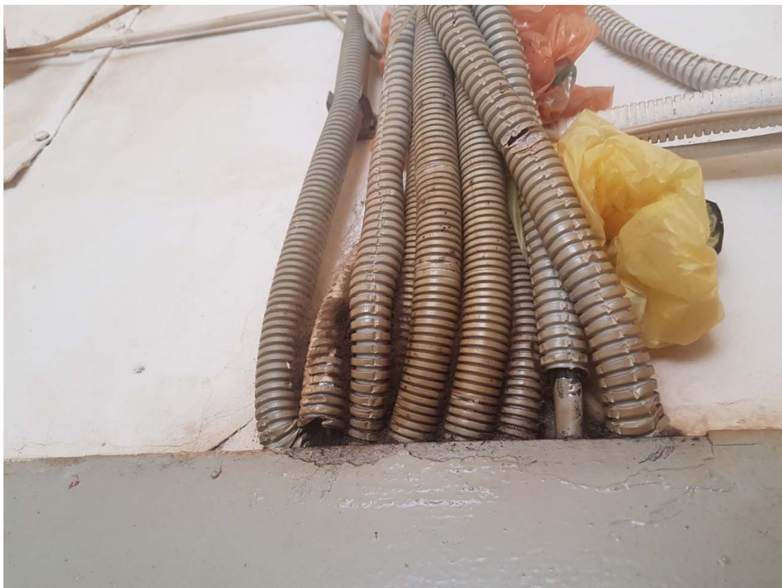
Оплавление защитного гофра из-за короткого замыкания в электропроводке
