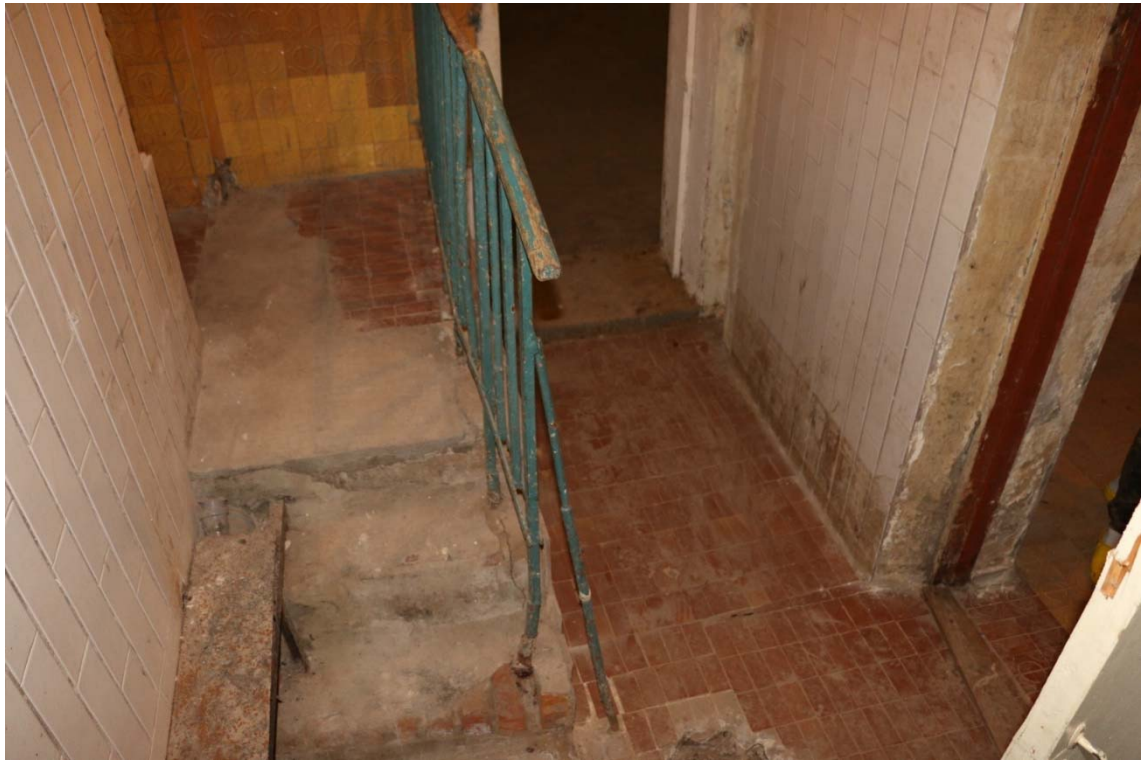
Разрушение ступеней и ограждения лестницы
