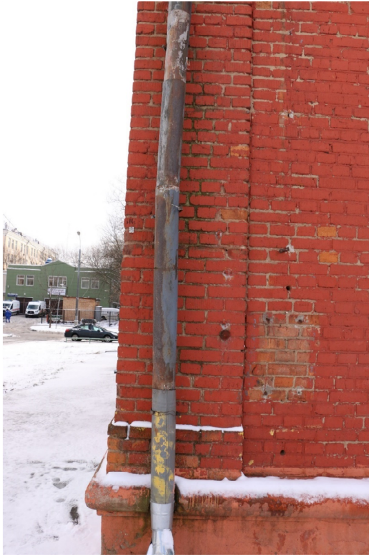
Разрушение отделки цоколя и стен. Повреждения в системе ливневого водоотвода
