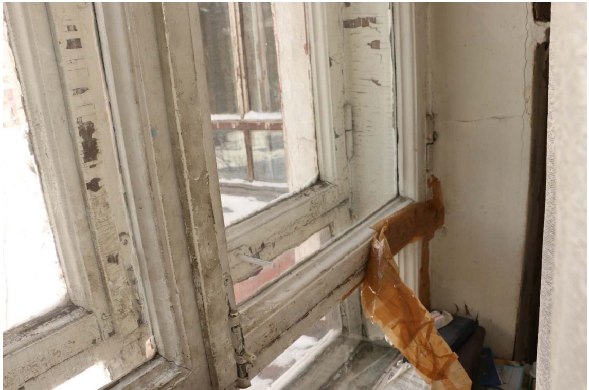
Трещины в оконных откосах. Рассыхание оконных переплетов, неплотное закрывание створок. Переплеты проклеены для защиты от сквозняков
