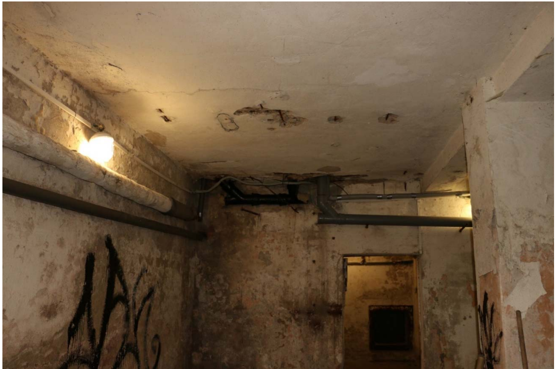
Разрушение отделки стен, колонны и перекрытия. Отстрел бетона в результате коррозии арматуры
