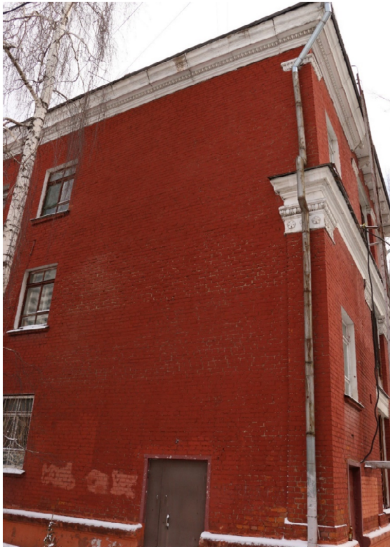
Потеки на карнизах, деформации ливневого водостока
