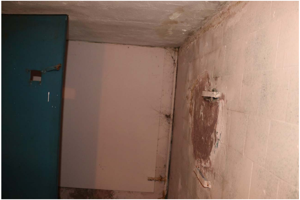
Разрушение отделки стен и перекрытия
