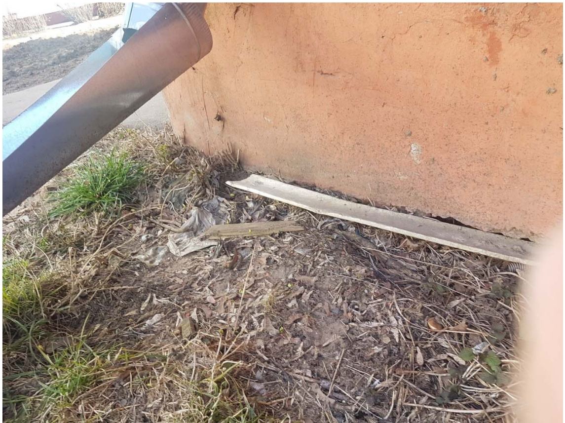
Отсутствует отмостка. Просадка грунта возле цоколя
