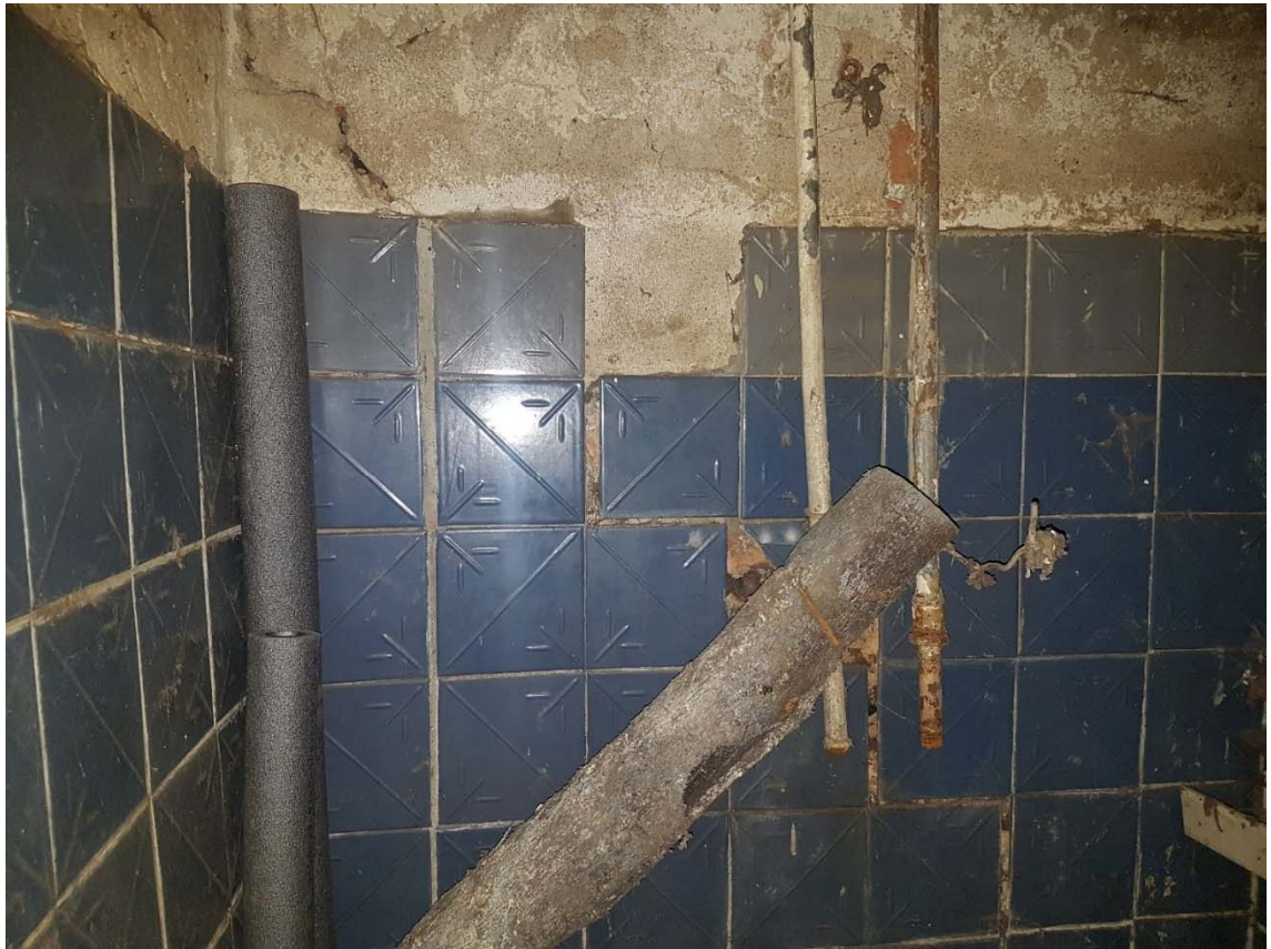
Разрушение отделки стен. Наклонная трещина в стене
