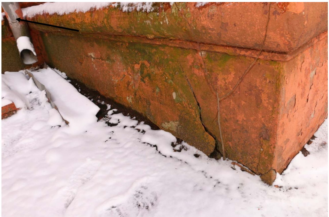
Разрушение отделки цоколя
