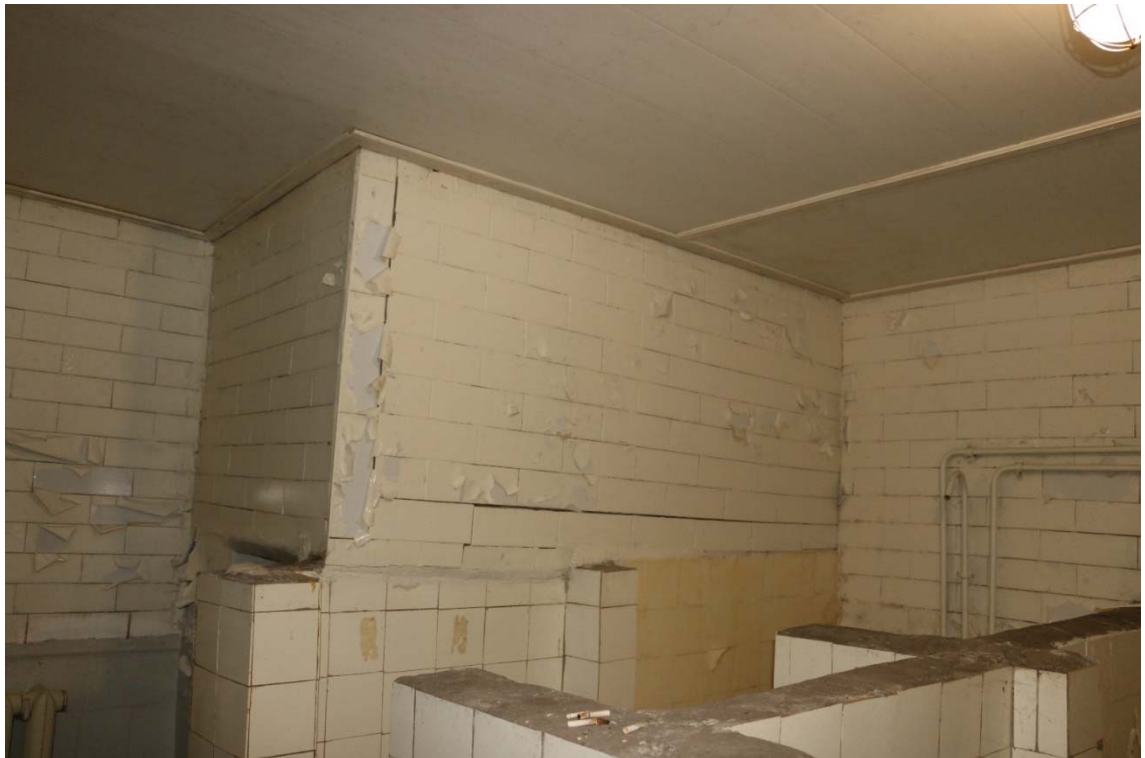
Разрушение отделки стен. Горизонтальная трещина в перегородке
