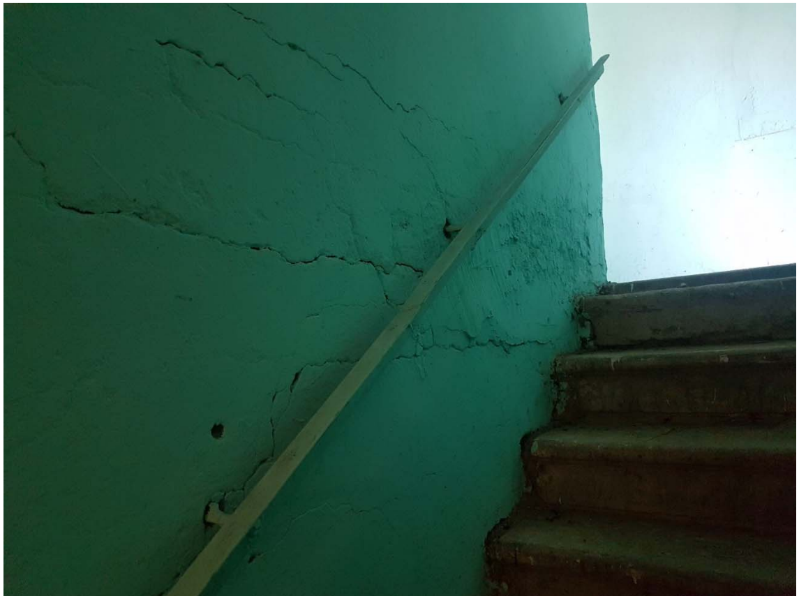
Горизонтальные трещины в стене лестничной клетки
