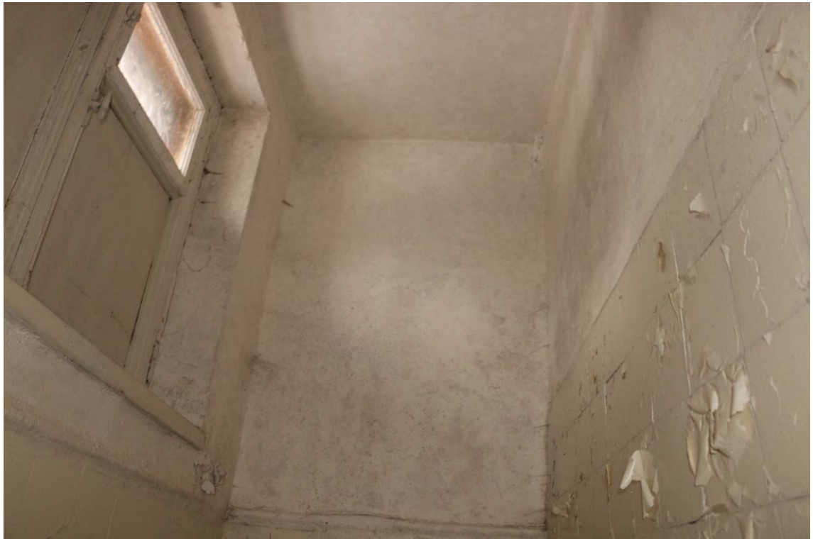
Разрушение отделочного слоя. Грибок на стенах и перекрытии
