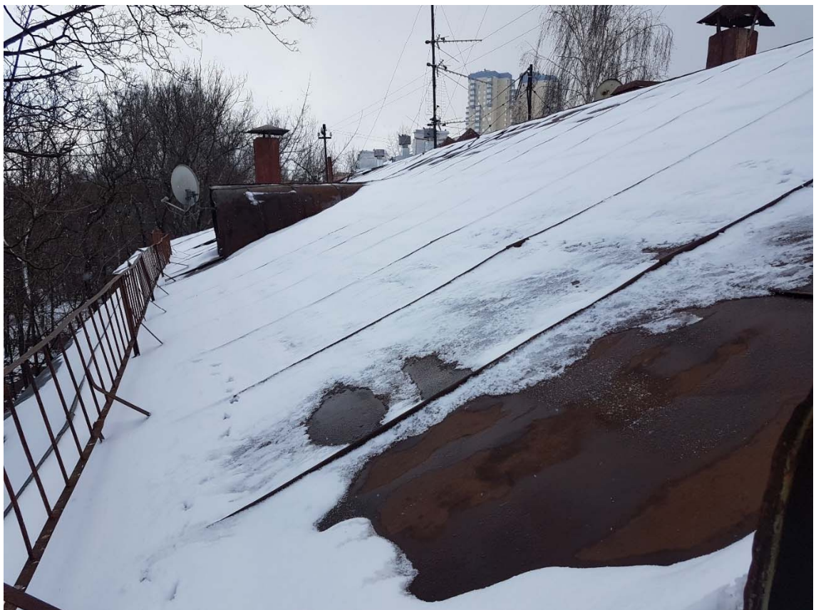
Коррозия кровельных листов и ограждения
