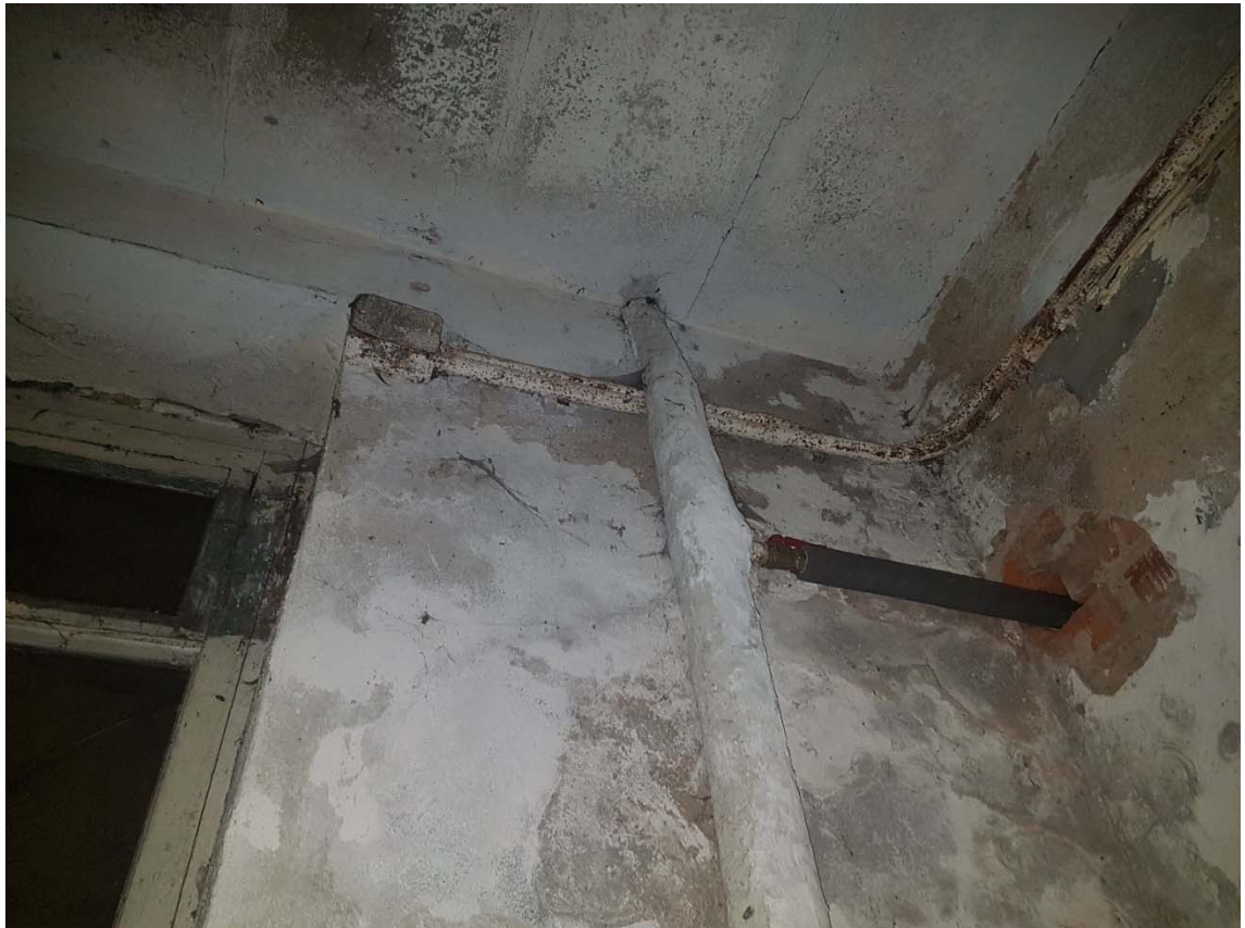
Разрушение отделки стен и перекрытия, трещины в межплитных швах. Коррозия трубопроводов
