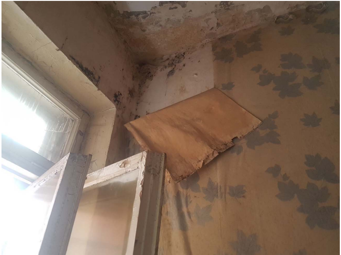
Отклеивание обоев от стен, грибок на стенах и перекрытии, разрушение отделки перекрытия, след замачивания на конструкциях
