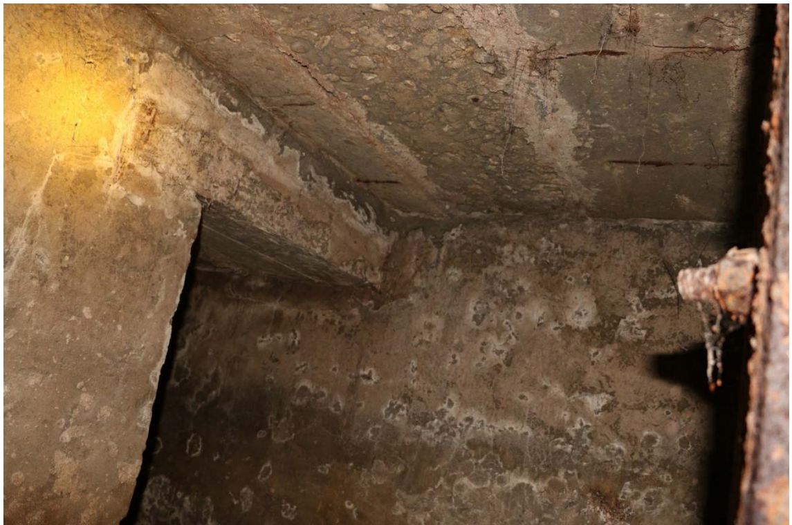
Разрушение отделки стен. Оголение и коррозия арматуры лестничной площадки
