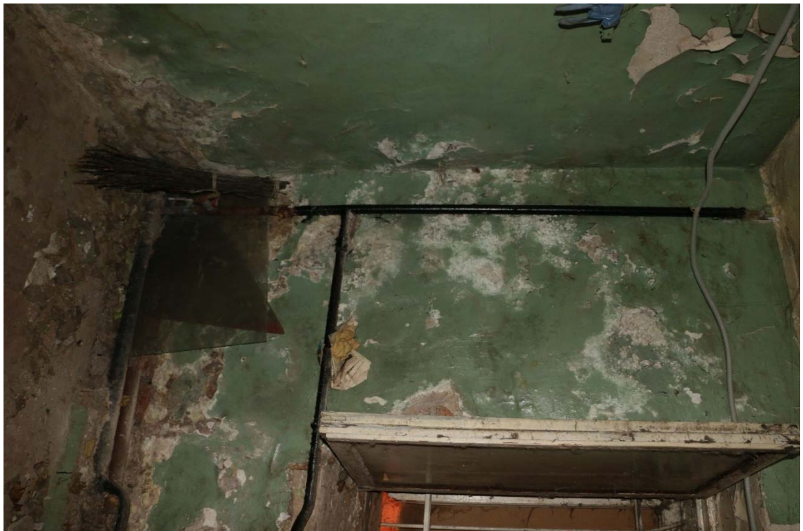
Разрушение отделки стен и перекрытия, грибок на стенах
