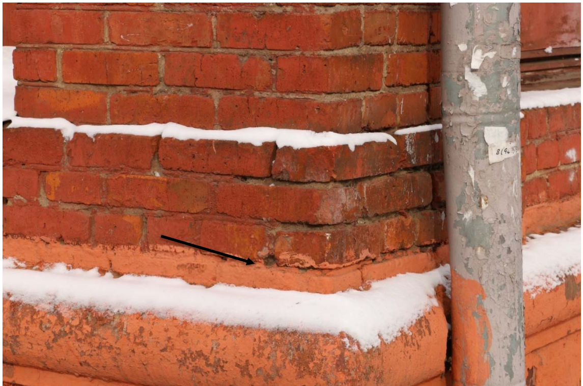
Выкрашивание раствора из швов кладки
