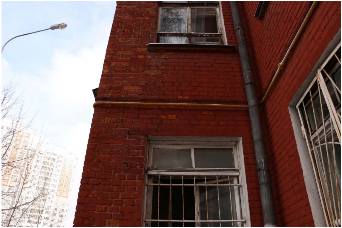
Вертикальная трещина в стене. Шелушение и осыпание окрасочного слоя
