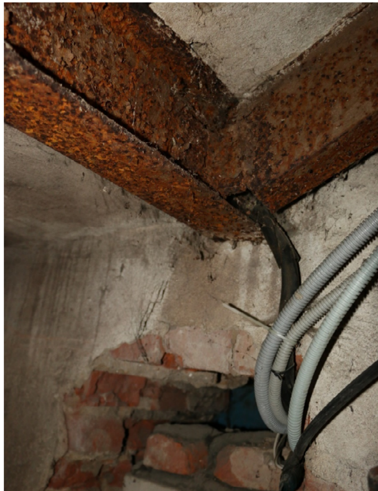
Пластинчатая коррозия балок лестницы
