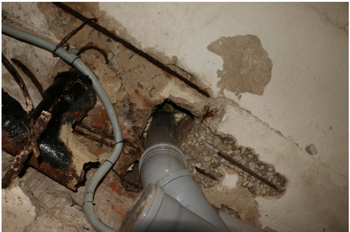
Отверстия в плитах перекрытия без усиления. Рабочая арматуры перекрытия перерезана
