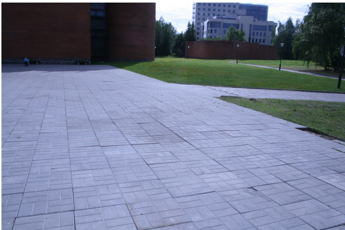
Фото 10. Межплитные швы выполнены несоосно (смещение плит). Превышение граней между смежными плитами
