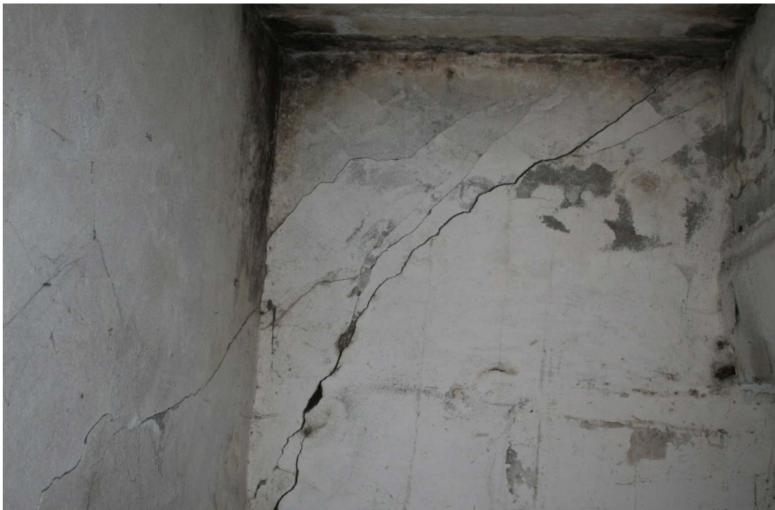
Фото 27. Наклонная трещина в стене стилобата. Следы протечек
