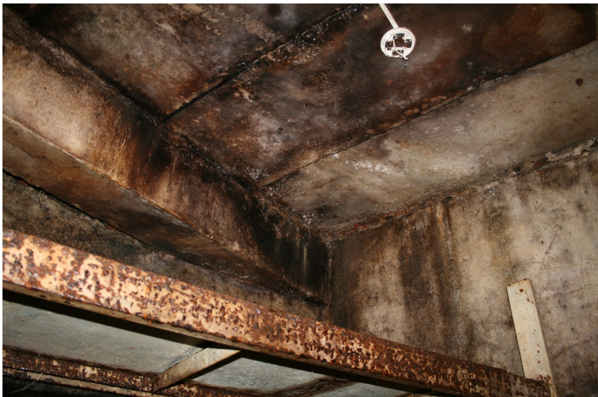
Фото 23. Следы протечек в помещениях стилобата
