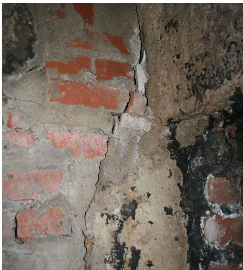
Фото 24. Трещины по контакту продольных и поперечных конструкций стилобата
