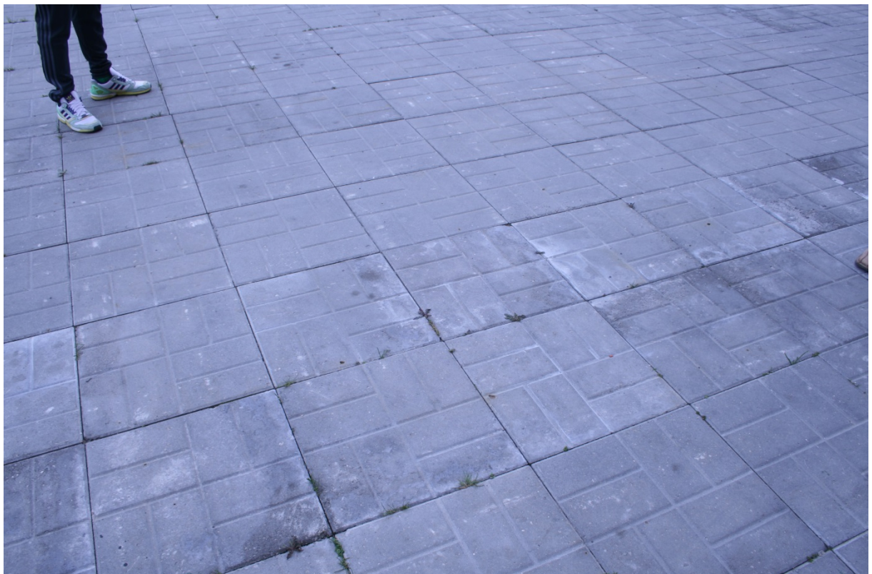
Фото 2. Высолы на плиточном покрытии
