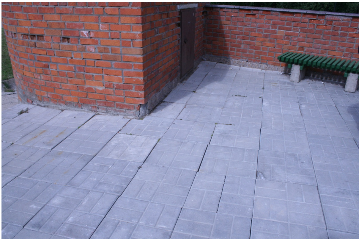
Фото 9. Лопнувшая бетонная плита. Межплитные швы выполнены несоосно (смещение плит). Превышение граней между смежными плитами
