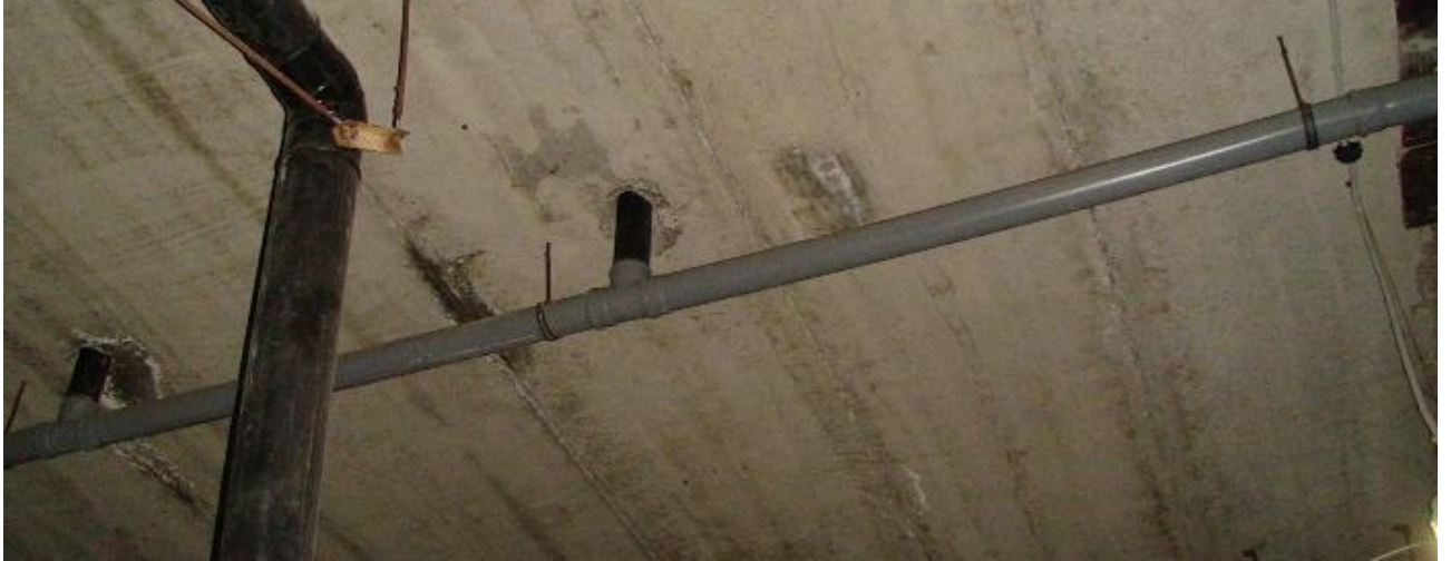
Дефект №3. Механические повреждения стен для создания проемов под пропуски инженерных коммуникаций
