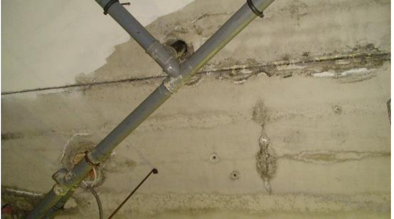
Дефект №4. Механические повреждения перекрытий для создания проемов под пропуски инженерных коммуникаций, образование протечек в этих местах
