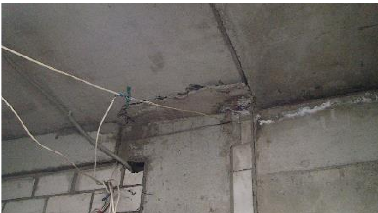
Дефект №1. Механическое разрушение опорного участка плиты перекрытия при монтаже
