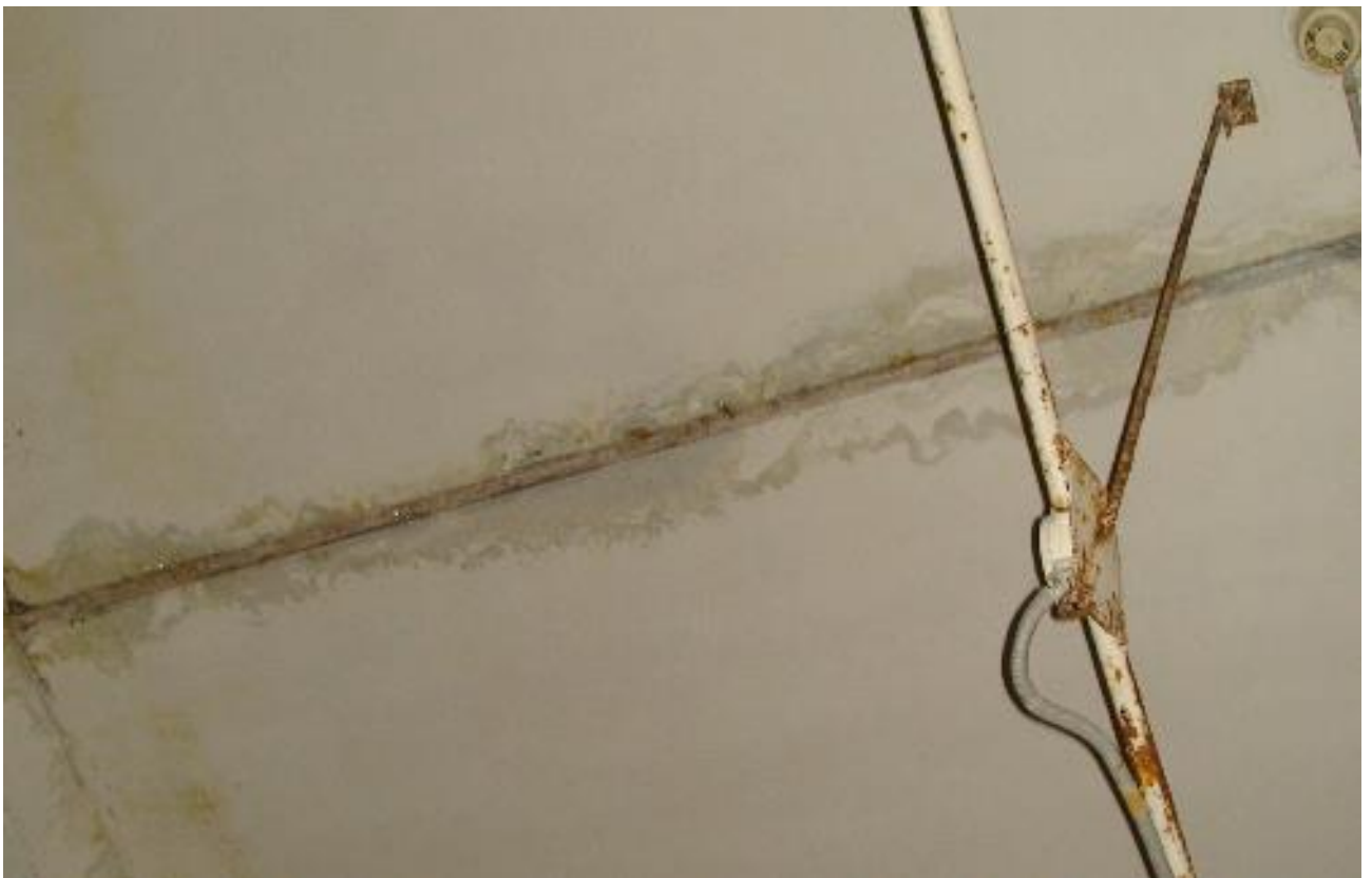
Дефект №6. Протечки сквозь перекрытия в зоне швов между плитами
