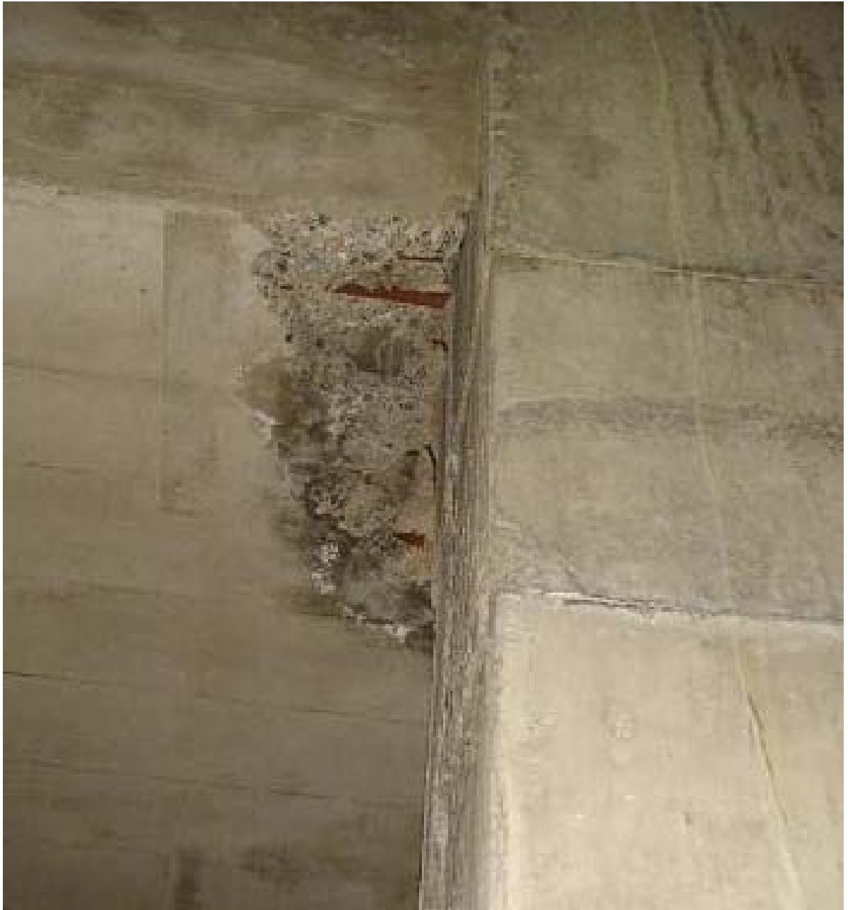
Дефект №1. Опираение плит перекрытия устроено по кирпичам
