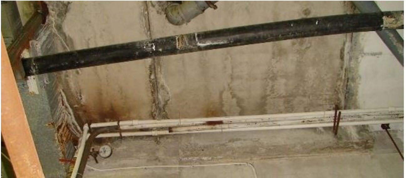
Дефект №6. Протечки сквозь перекрытия в зоне швов между плитами
