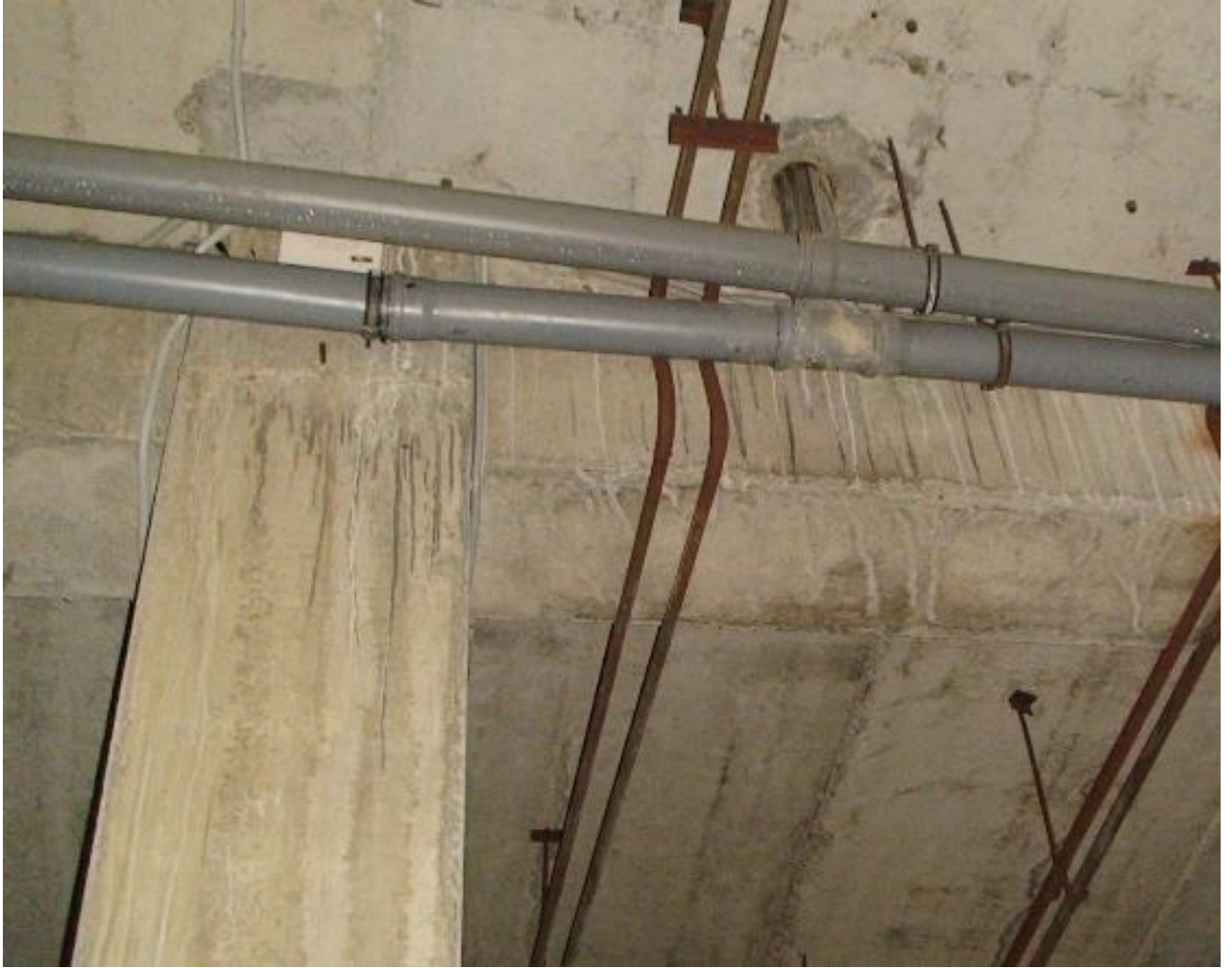
Дефект №12. Протечки по поверхностям колонн
