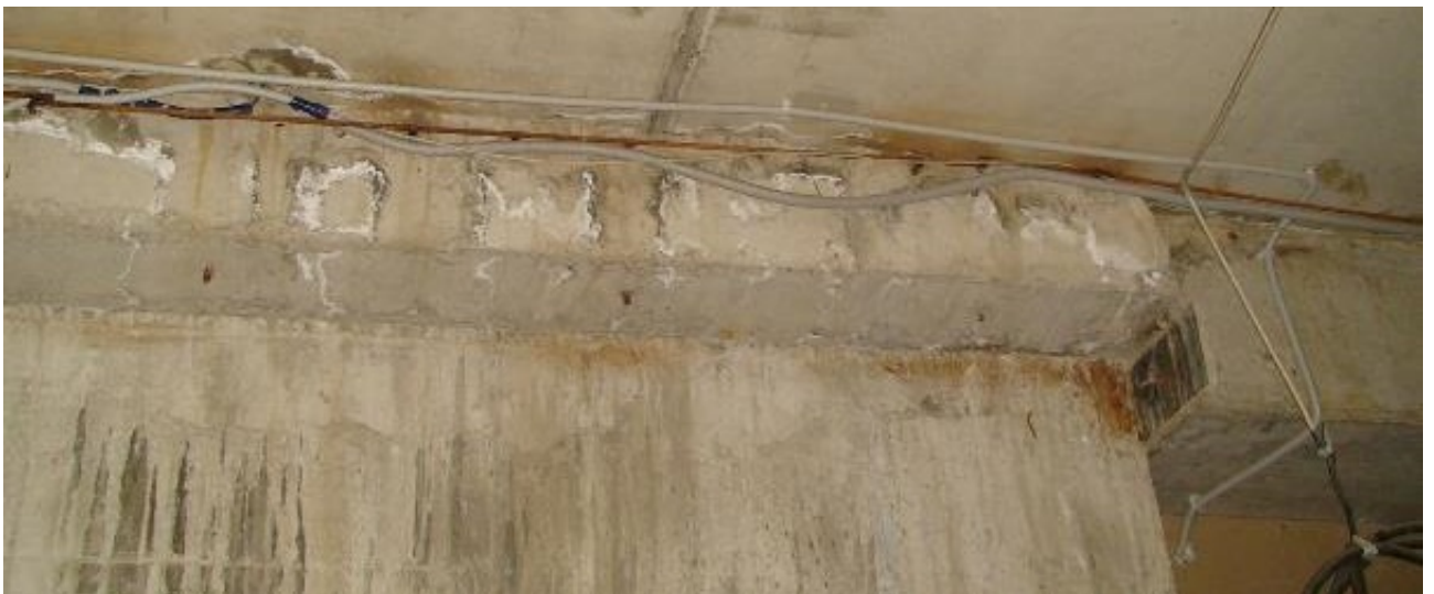
Дефект №13. Регулярное увлажнение стен протечками с перекрытий
