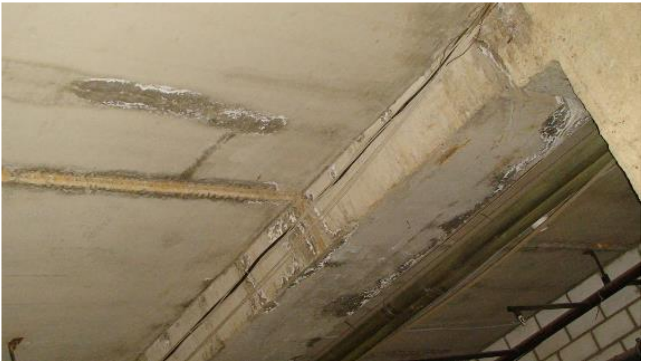
Дефект № 5. Коррозия материалов сборных железобетонных балок перекрытий вследствие протечек с вышележащих перекрытий. Защитный слой бетона карбонизован на всю глубину, коррозия арматуры, начало коррозионного растрескивания защитного слоя бетона под воздействием продуктов коррозии арматуры
