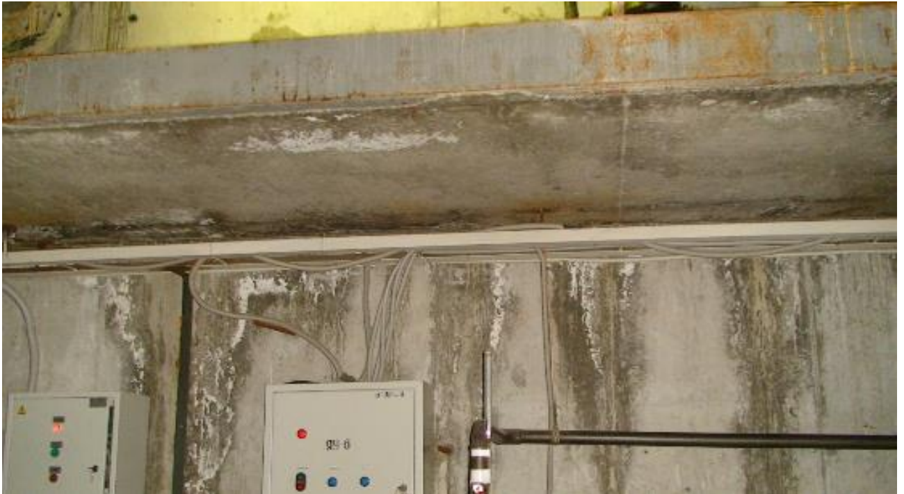
Дефект №13. Регулярное увлажнение стен протечками с перекрытий
