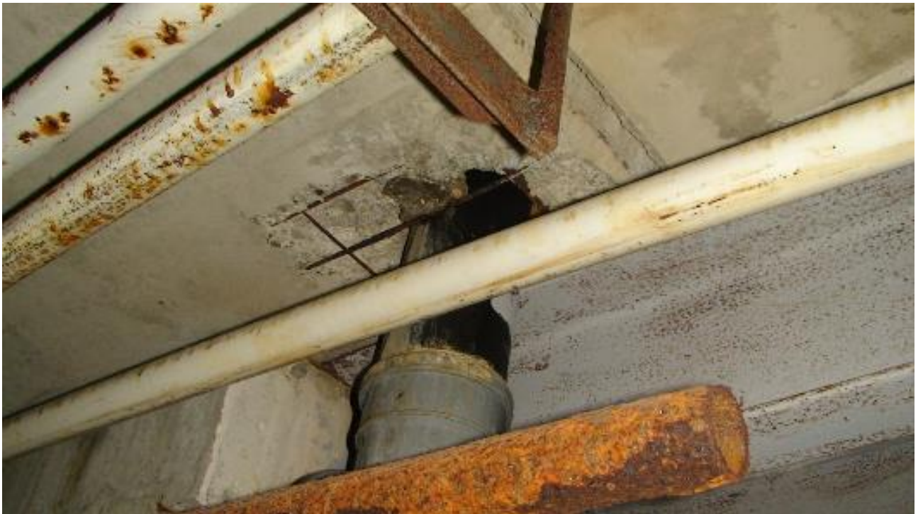
Дефект №3. Механические повреждения стен для создания проемов под пропуски инженерных коммуникаций
