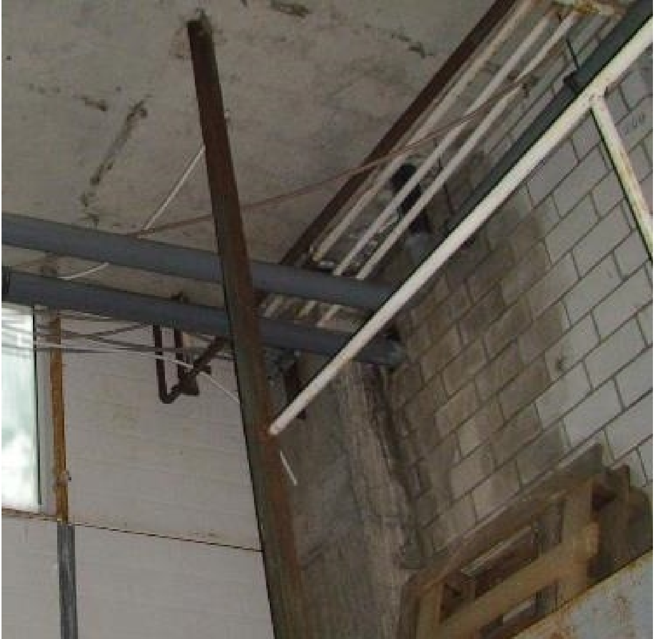
Дефект №13. Регулярное увлажнение стен протечками с перекрытий
