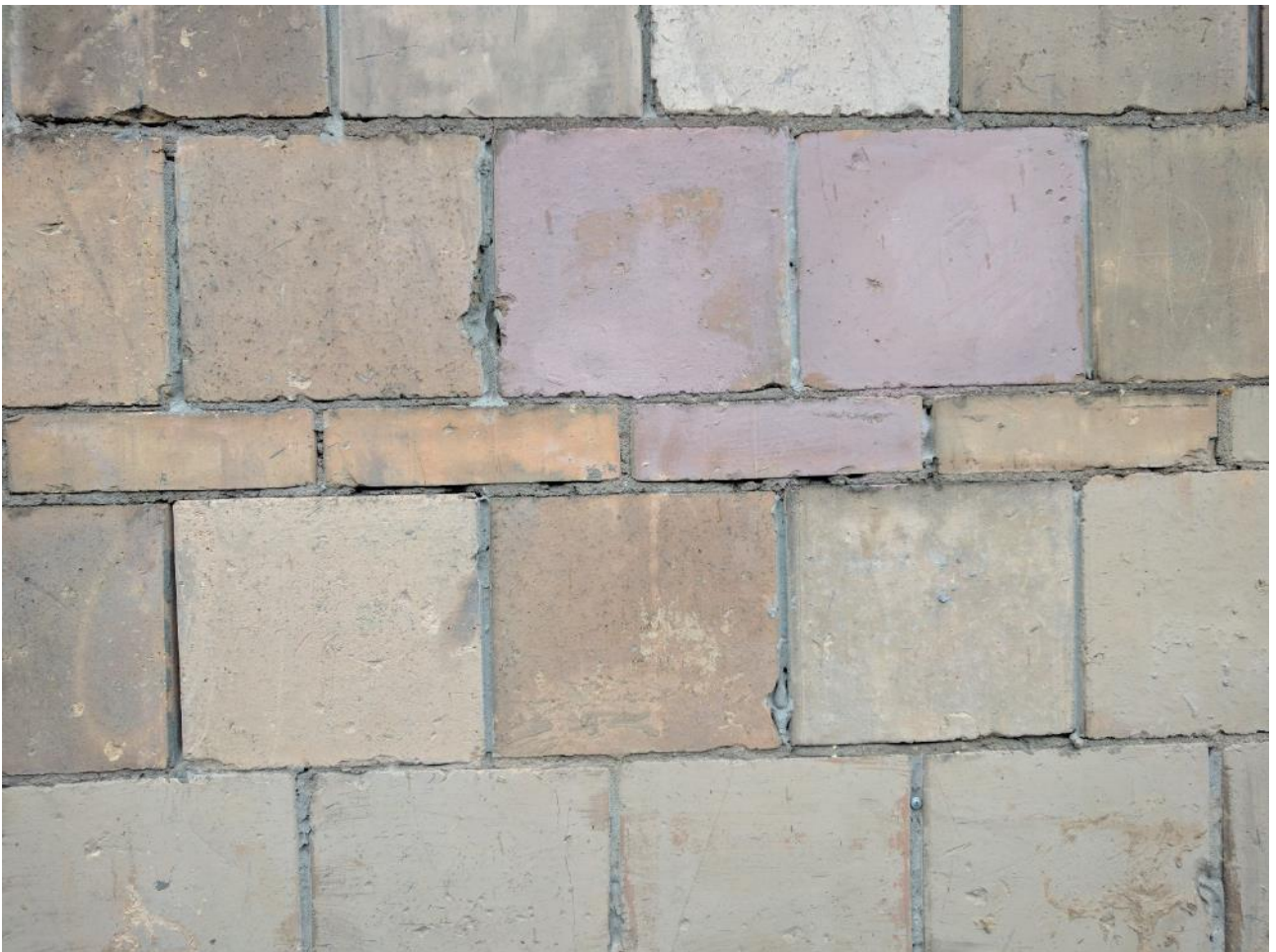
Фото П2.2. Дефекты лицевой кладки
