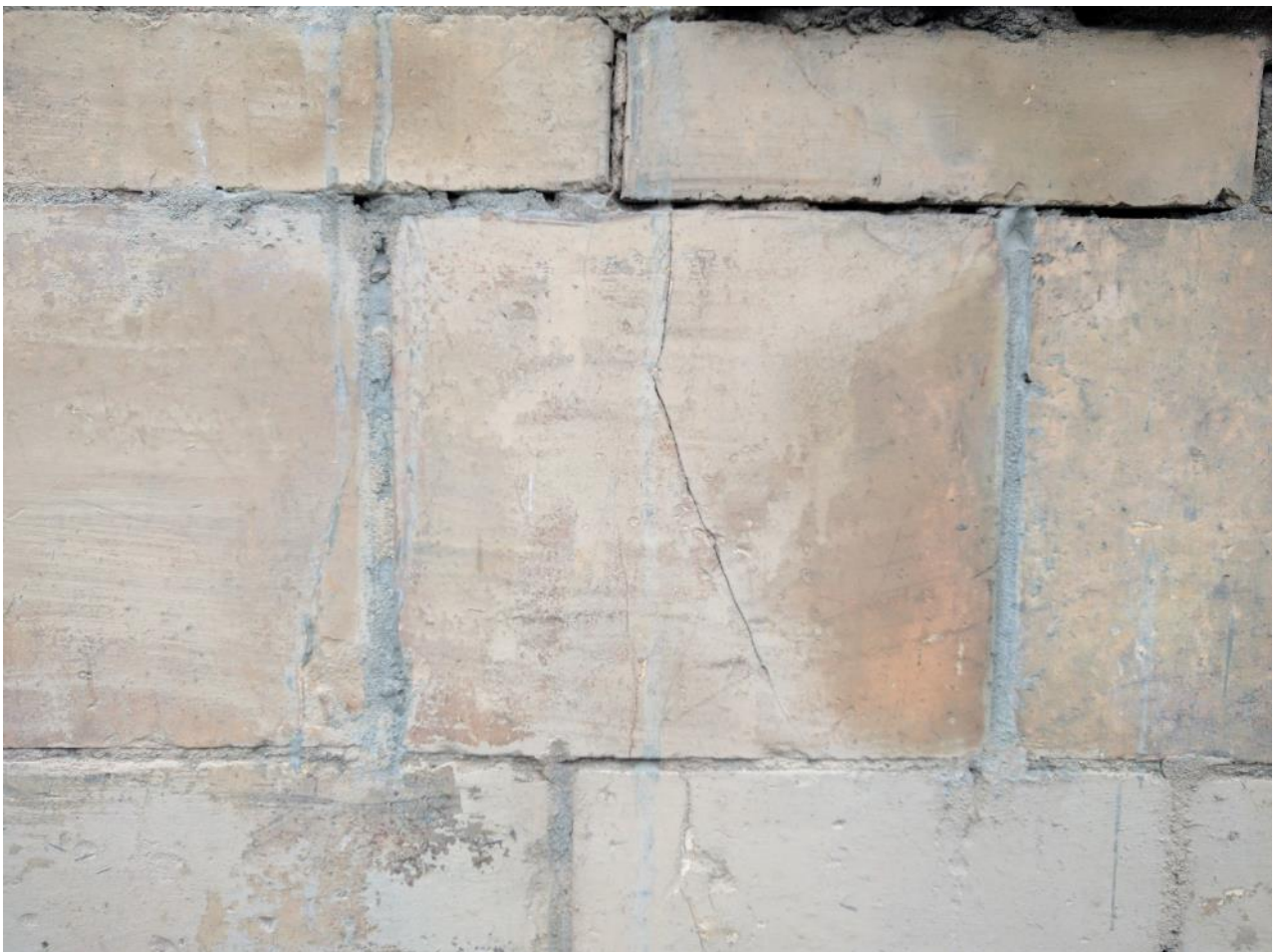
Фото П2.4. Дефекты лицевой кладки
