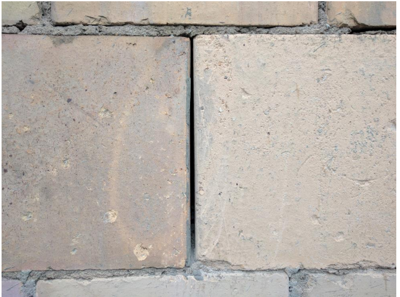
Фото П2.3. Дефекты лицевой кладки
